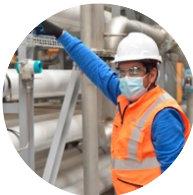
1. PUESTA EN MARCHA DESALADORA ATACAMA: Se trata de la primera desaladora estatal y una de las más modernas a nivel mundial. Nueva Atacama será la operadora de esta instalación.
